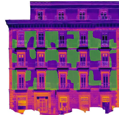
Anomalie termiche Individuazione delle anomalie termiche su termofoto generale
